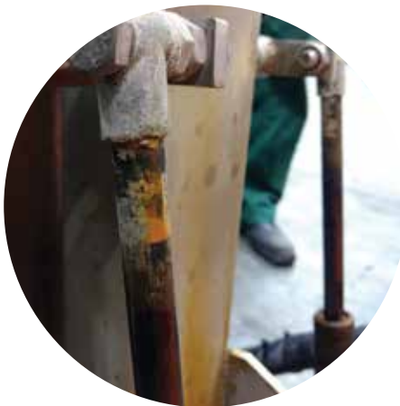
↑ Поврежденные ржавчиной гидроцилиндры
