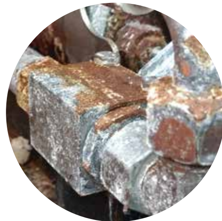
↑ Поврежденные ржавчиной фитинги проводов и элементы гидросистемы
