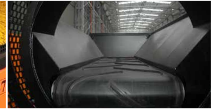
Bewehrtes Fördererband des Aufgabesiebes
