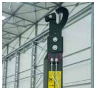
Para wyjść instalacji hydraulicznej na haku
