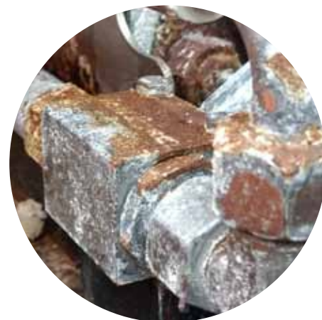
↑ Skorodowane okucia przewodów oraz elementy hydrauliki
