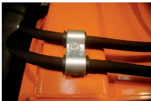
Mocowania przewodów hydraulicznych
