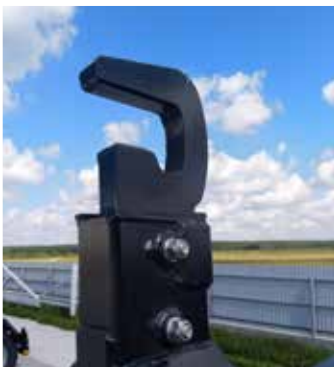
Hak bez zabezpieczenia kontenera
